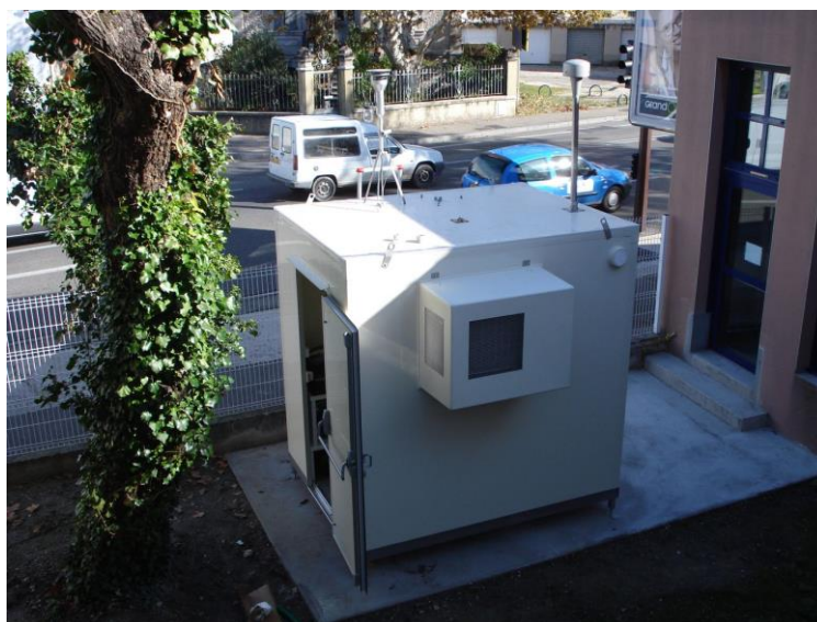
Station de mesure sur l'avenue Pierre Sépard à Avignon.
