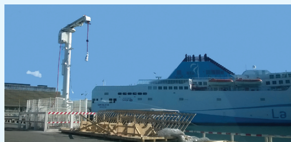
Prise de raccordement d'un navire de la Méditerranée, source : GPMM
