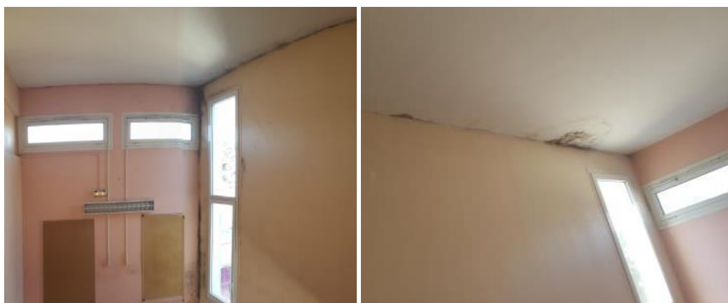
Photographie 86 : Moisissures présentes dans les cages d'escalier d'accès au 1 er étage du bâtiment Valmont Redon
