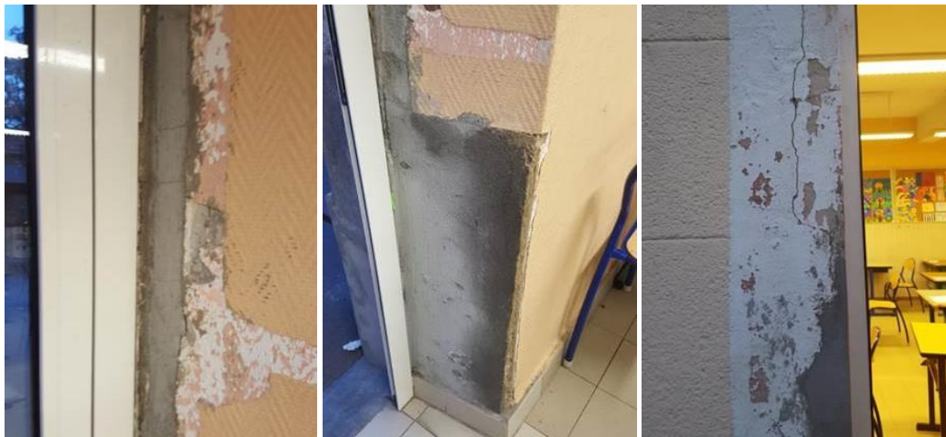
Photographie 87 : Problème d'humidité de l'enduit intérieur de la salle de classe SDC2 de l'école Chartreux
