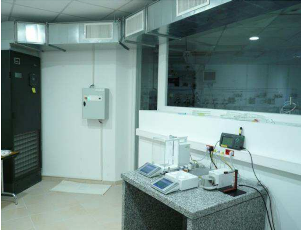
Photo 3 : Vue d'ensemble du laboratoire de gravimétrie d'Air PACA
