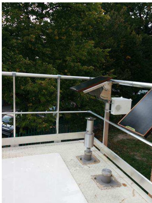
Photo 1 : Micro-capteur, fixé à l'intérieur du boîtier blanc (homesense), équipé de son panneau solaire
