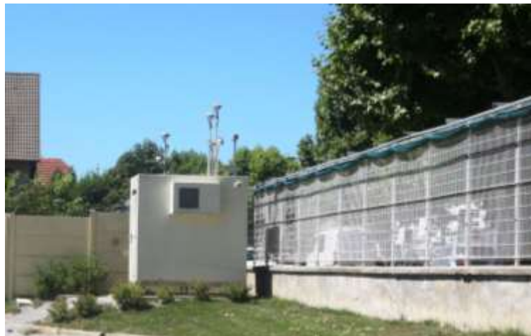
Station de mesure sur l'avenue Jean Jaurès à Gap (stade municipal)
