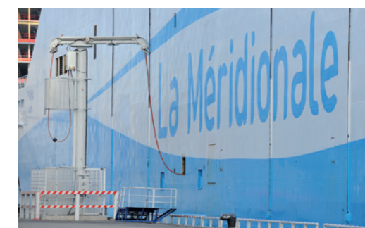
Alimentation électrique à quai. Marseille, La Méditerranéenne © Port de Marseille Fos
