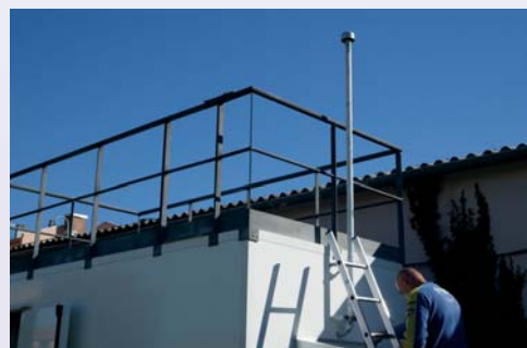
Équipement de sécurité sur le toit de la station de Châteauneuf-les-Martigues.
