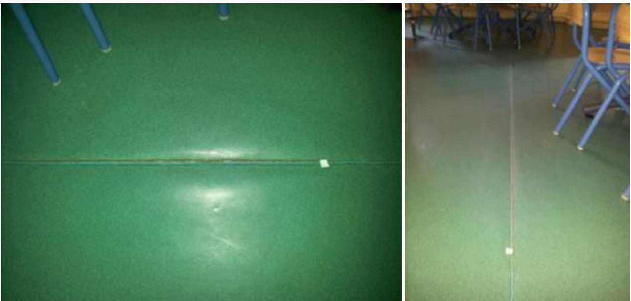
Figure 9 : Joint d'étanchéité retiré du réfectoire B
