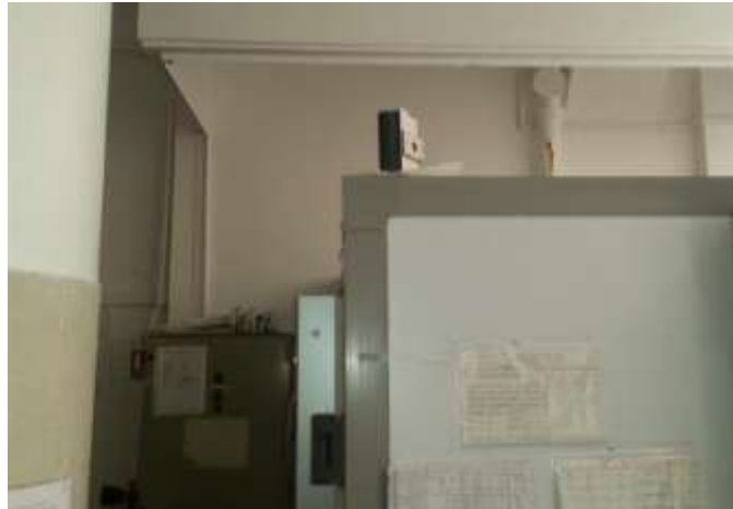
Figure 8 : Positionnement de la balise Fireflies dans la cuisine (Salle A)
