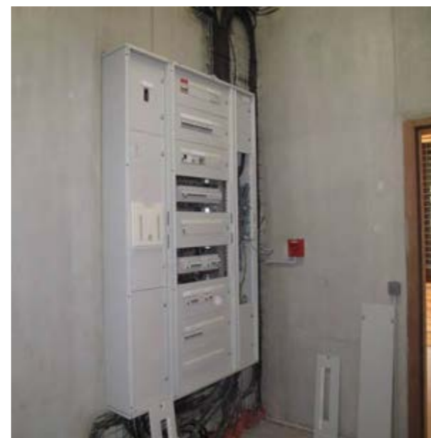
Figure 3 : Tableau électrique émetteur de champ électromagnétique
