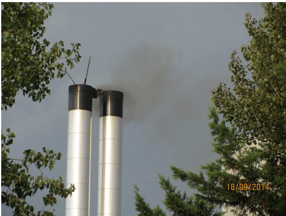
Figure 17 : photo de la cheminée de la chaufferie lors d'un incident de fonctionnement (source : CIQ)
