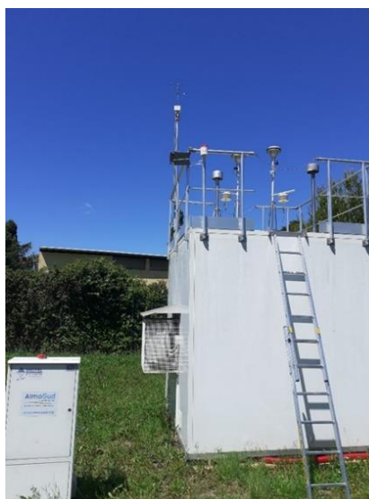
Figure 1 : Installation de la station de mesure dans le quartier de Sousquières
